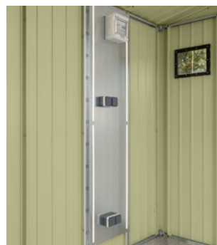
Panneau électrique avec prises de courant, éclairage et raccordement courant haute tension en option Largeur x hauteur : 47 x 180 cm
